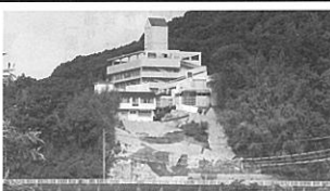
崩壊した斜面 (現場の様子)
